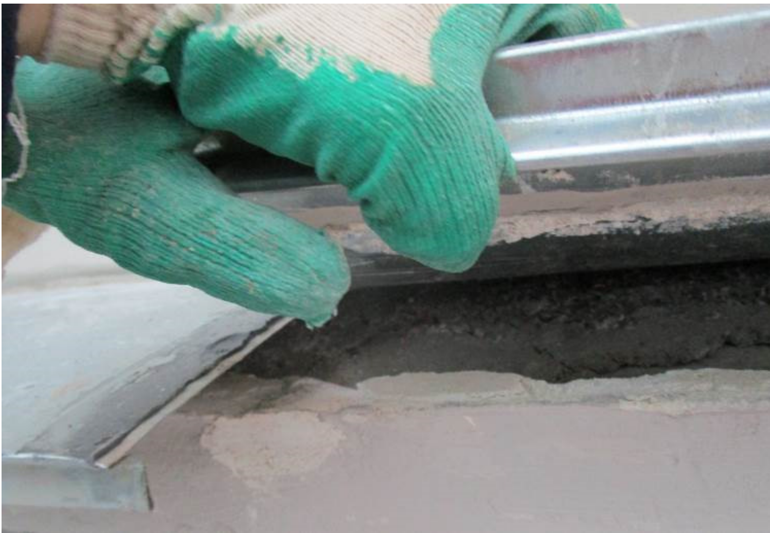
Илл. 17 Недопускаемое «прищипывание» зазора между штукатурным полем, стяжкой и линейным покрытием
