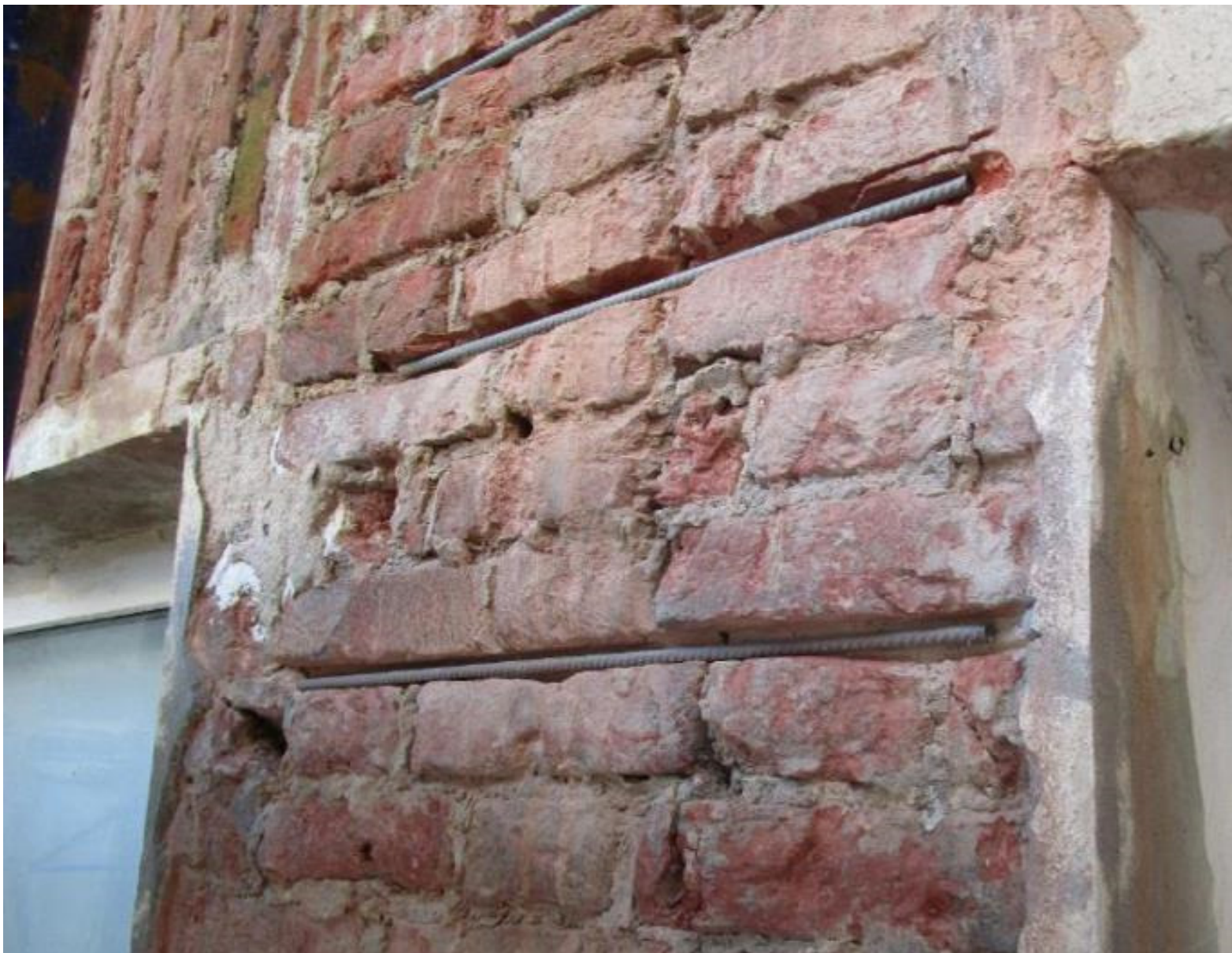
Илл. 3 Установка арматуры в кладочный шов. Предварительное заполнение штробы сложным раствором обязательно!
