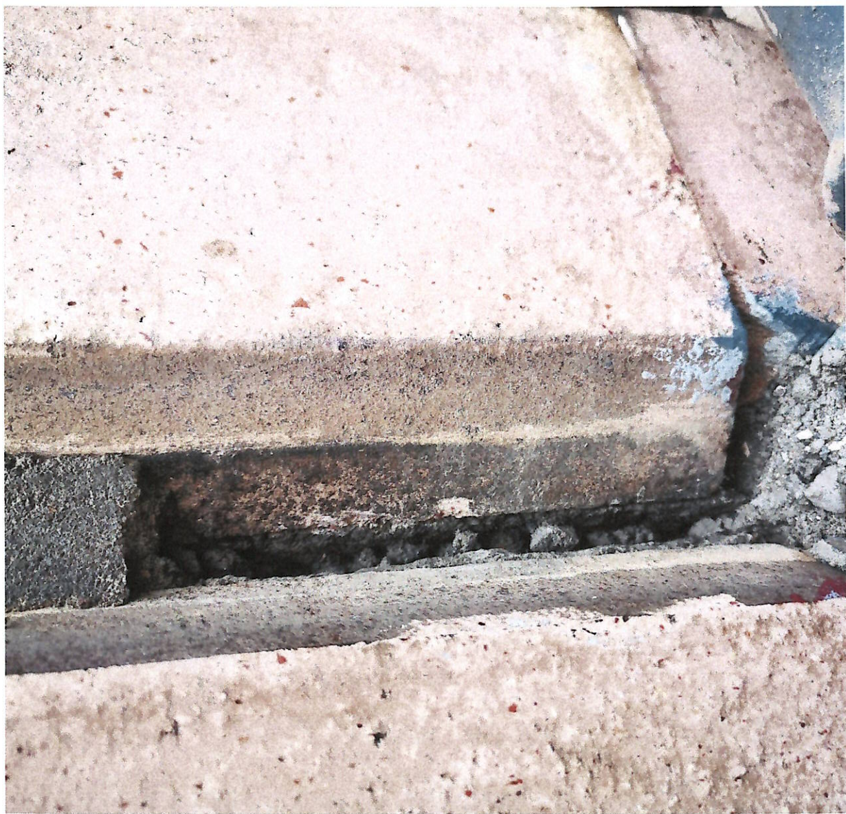
Дефекты монолитных межпанельных швов
